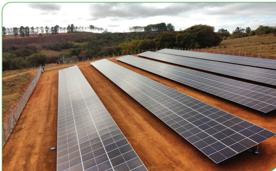
Usina fotovoltaica instalada na Sede da Pró-Ambiental, no município de Lavras
